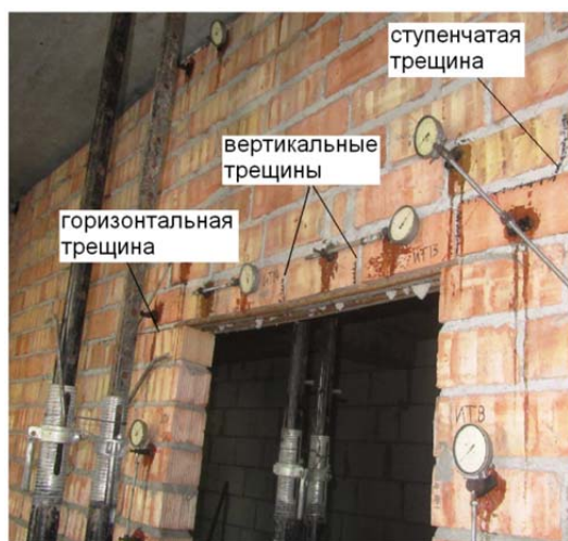
Рисунок 5 – Характер трещинообразования в перегородке, не связанной со стенами
